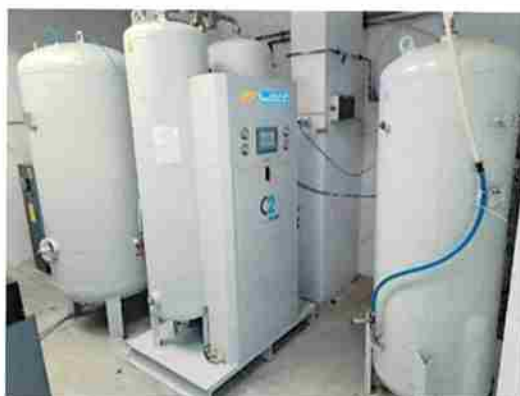
GENERATOR DE OXIGEN
